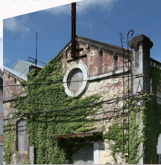
遠賀川水源 ポンプ室 （福岡県中間市）
